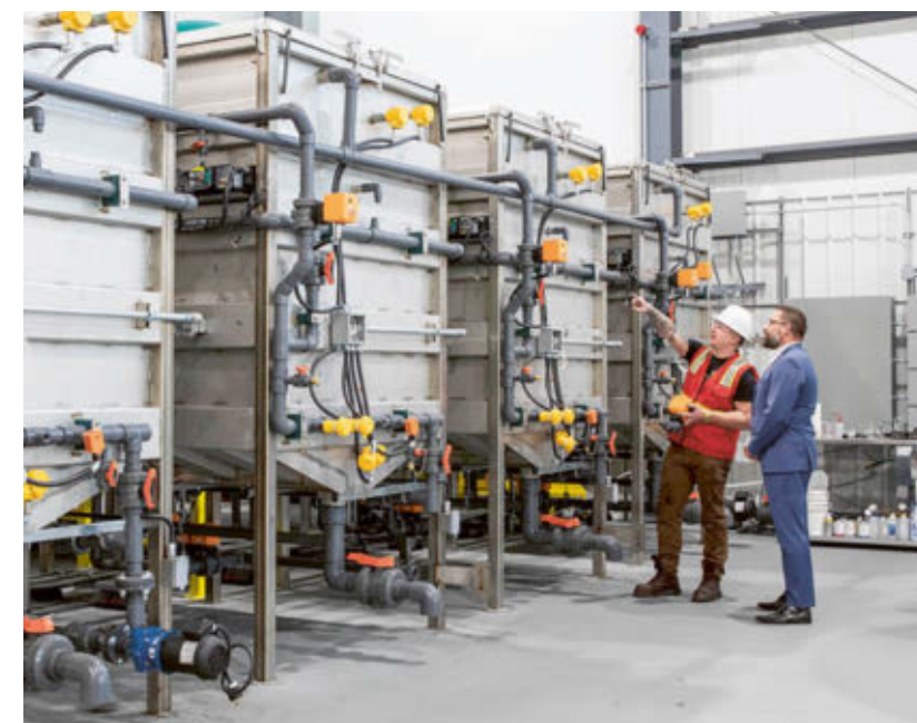
↑ GF管路系统提供的全套解决方案包括阀门、驱动装置、测量设备和控制器，用于控制巨型储罐内的生物碳加工。
