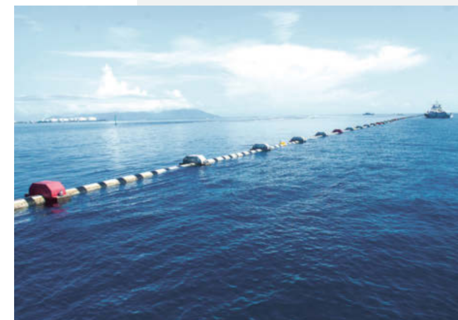
↑ Ein fast vier Kilometer langes Rohr kühlt das Krankenhaus der Hauptstadt Tahitis mit Meerwasser.
