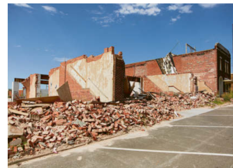
↑ Nella città di Seminole molte case sono state distrutte dai tornado primaverili.
